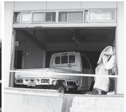
流された車が放置された店舗
